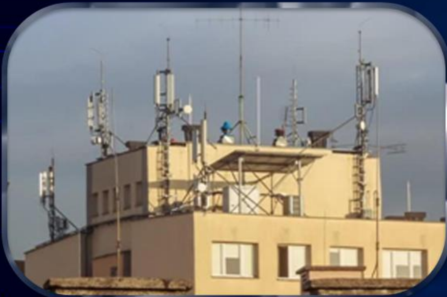
REPETITORI I BAZNE STANICE
