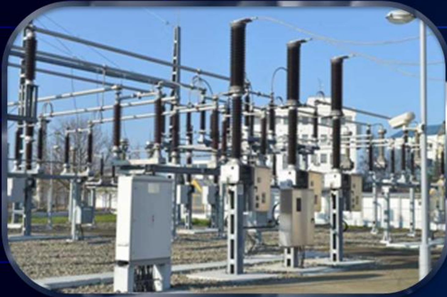
TRAFOSTANICE ZA DISTRIBUCIJU
